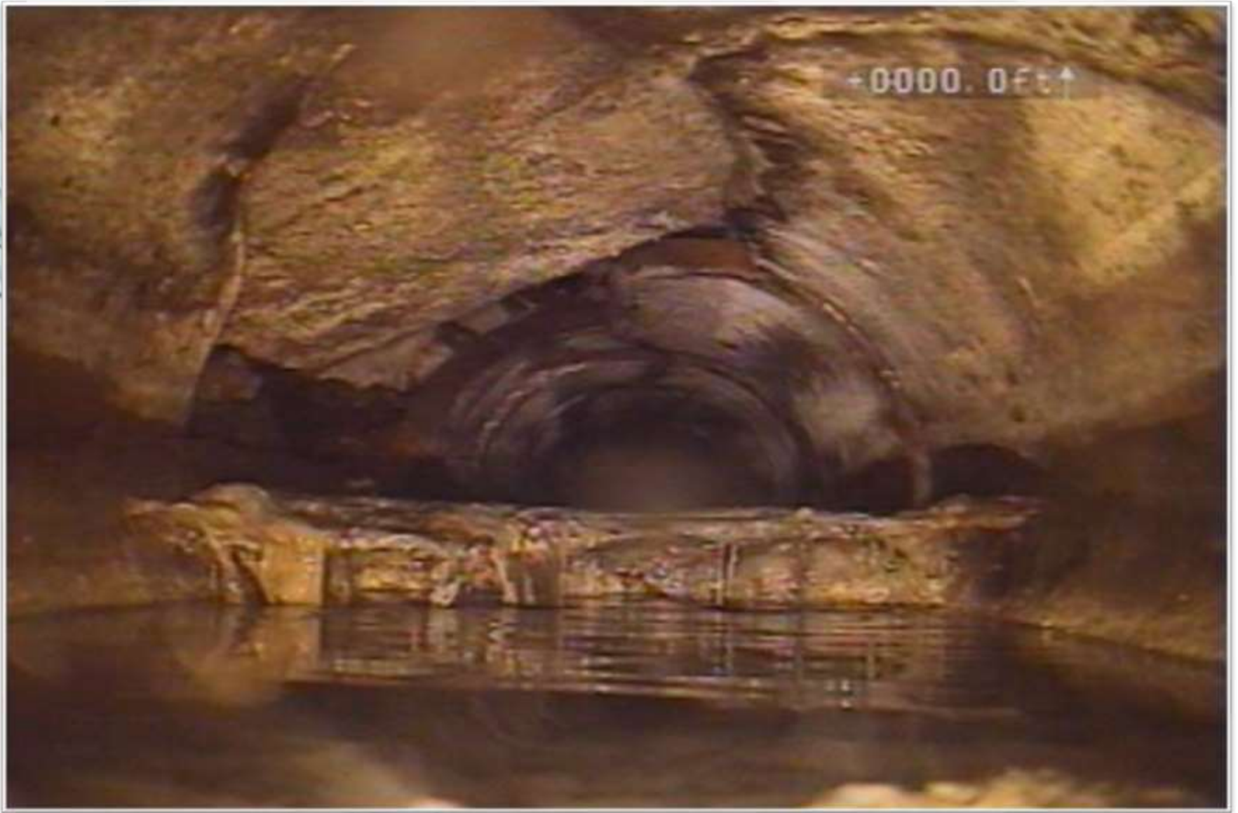
Colapso de la parte superior de la tubería del colector Montevideo, Colonia Lindavista, Deleg. Gustavo A. Madero.
