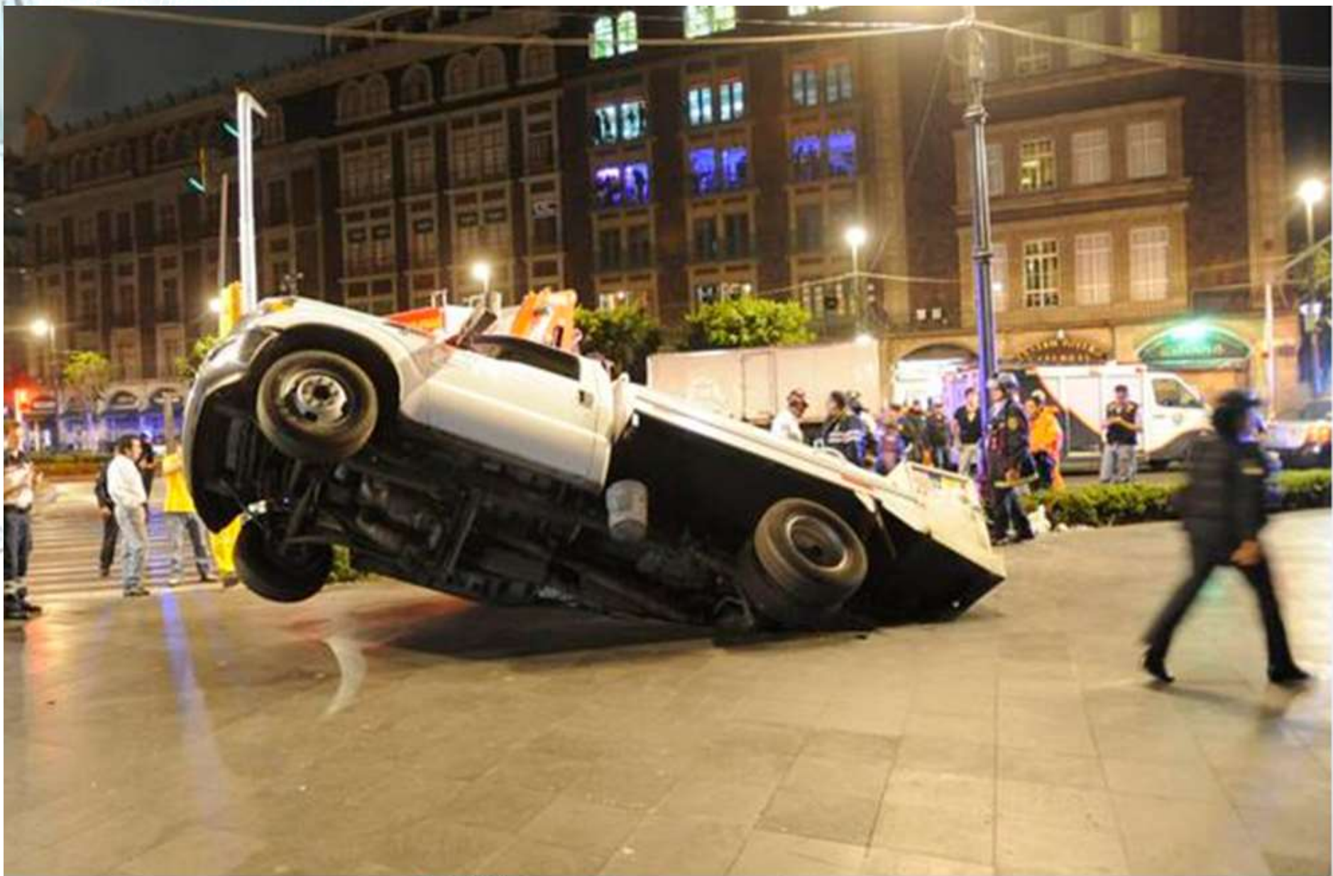
Hundimiento Colector 5 de Mayo, frente a la Catedral 01:00 hrs am.
